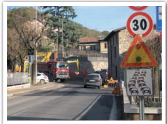
Rete fognaria consorziale Asta del Gandovere
